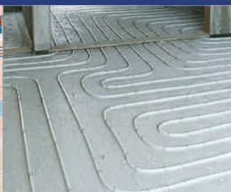
Система отопления - теплый пол
